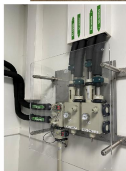
Alimentation eau osmosée de dialyse
