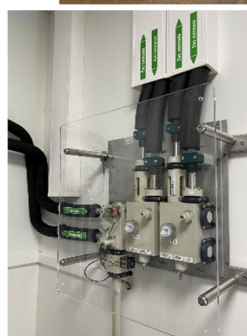
Alimentation eau osmosée de dialyse
