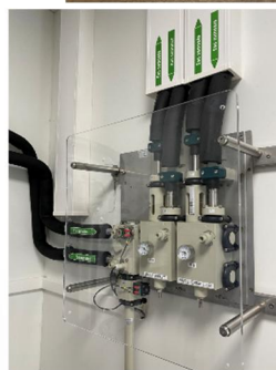
Alimentation eau osmosée de dialyse
